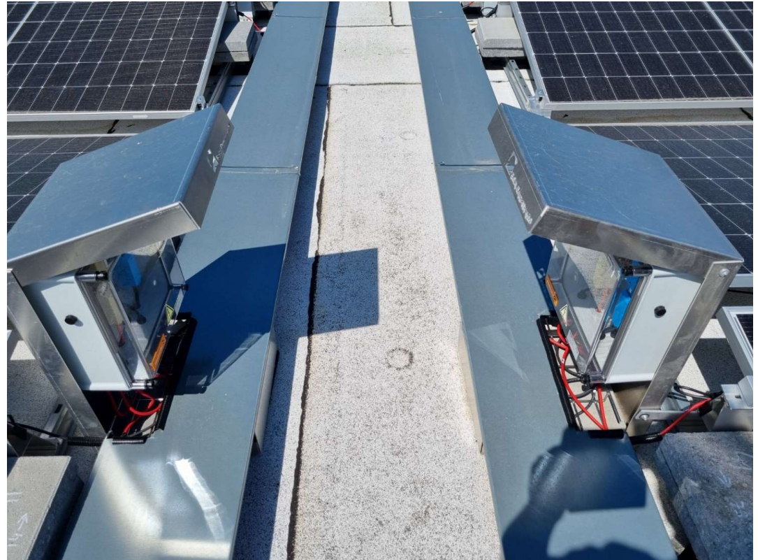
Basis combinerboxen op het dak
